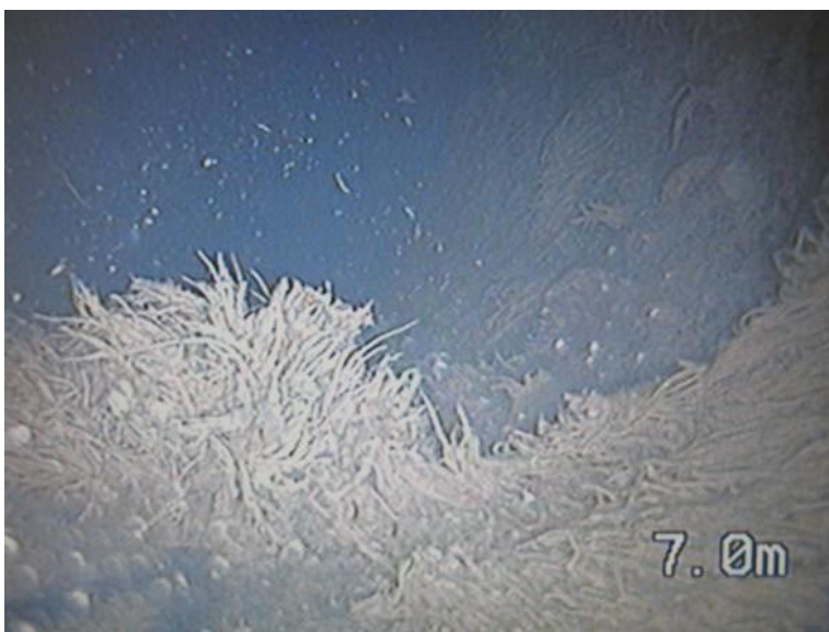
Figur 37. Bakterier på indersiden af rør fra beluftningsrende til forfilter på dansk vandværk (Olafsson 2008).
