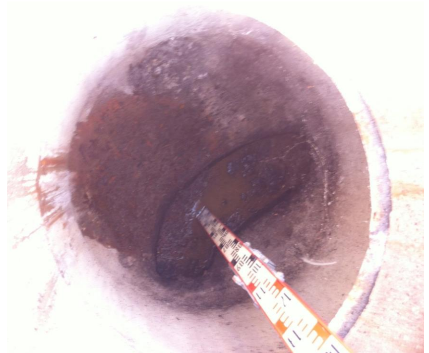
Slamophobning i kloakbrønd, Thyborøn
