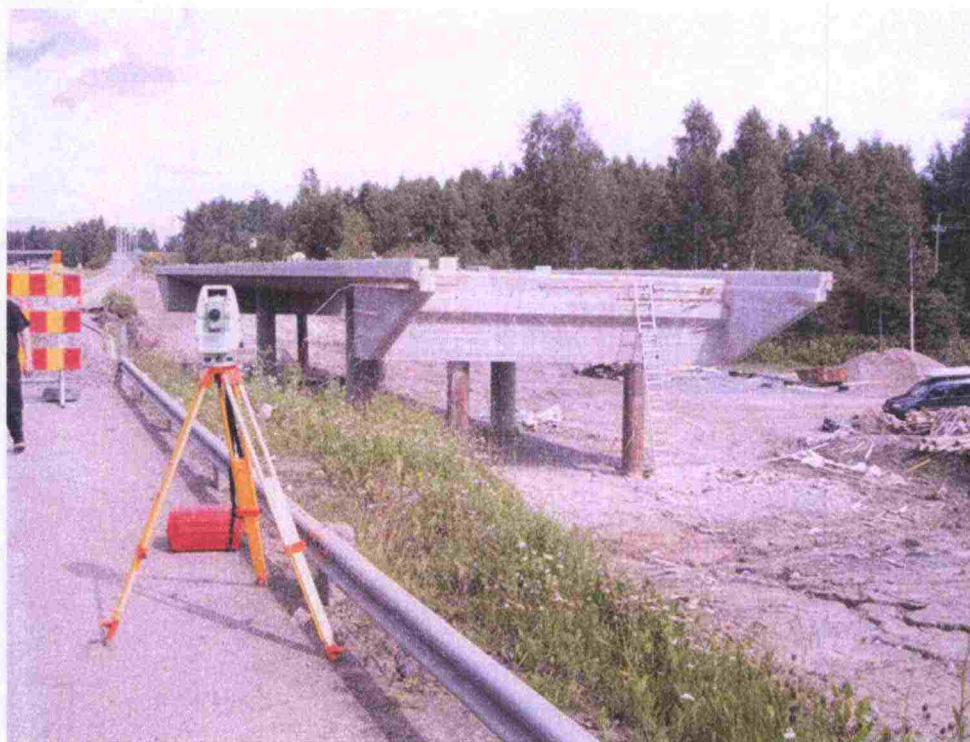
Kuva 31. Takymetrille valittu kojeasema. Sijoittelulla saatiin aikaan näkymät sekä sillan kannen päälle että alle asetettuihin tähyspisteisiin.
