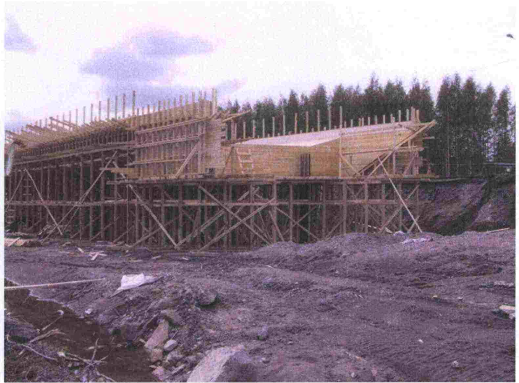
Kuva 28. Muotin tukirakenteita ei pystynyt keilaamaan.
