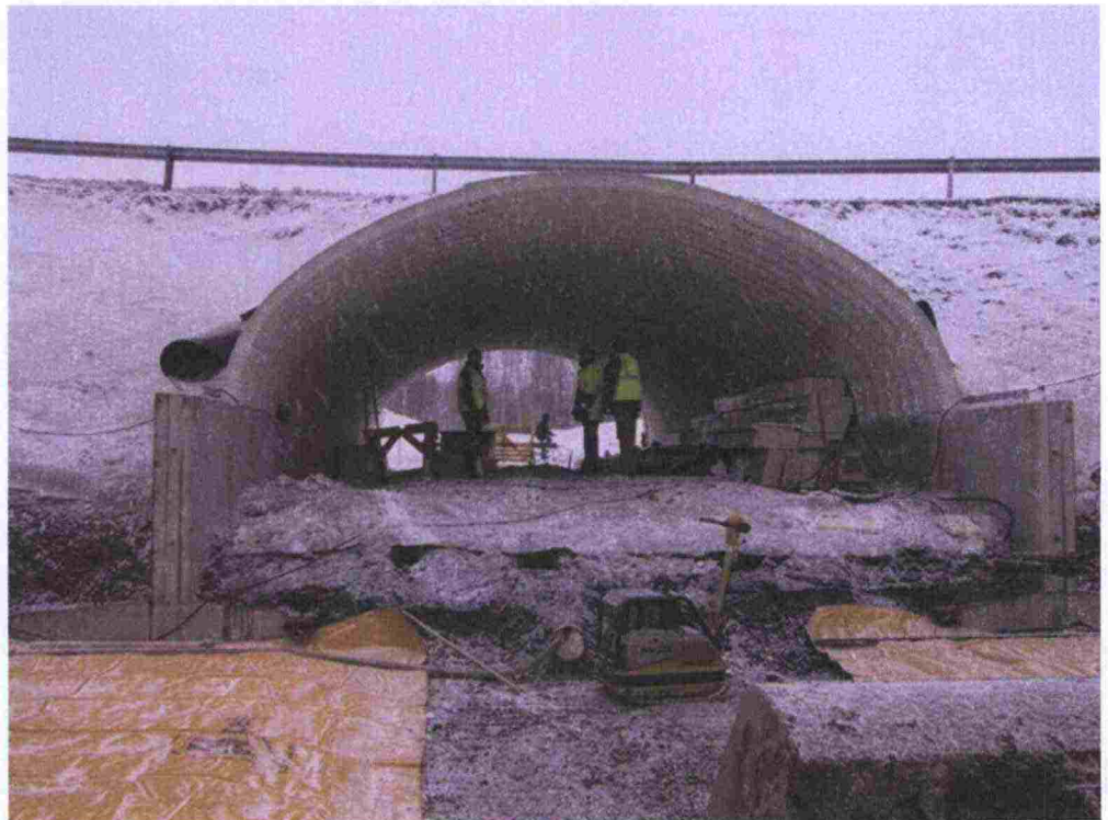
Kuva 53. Oulun Joutsentien pilottisillan pohjoinen osa. Kuvassa näkyvät teräsbetoniset perustuselementit sekä niihin tukeutuva teräksisistä kaarielementeistä koostuva päällysrakenne.
