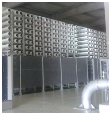
Figura 6. Imatge de la planta d'osmosi inversa de l'ETAP de Sant Joan Despí (Aigües Barcelona).
