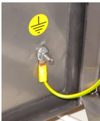
Figura 36 – Toma a tierra
