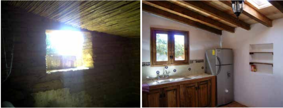
Fotografías 8 y 9. Antes y después de una rehabilitación de casa de adobe
