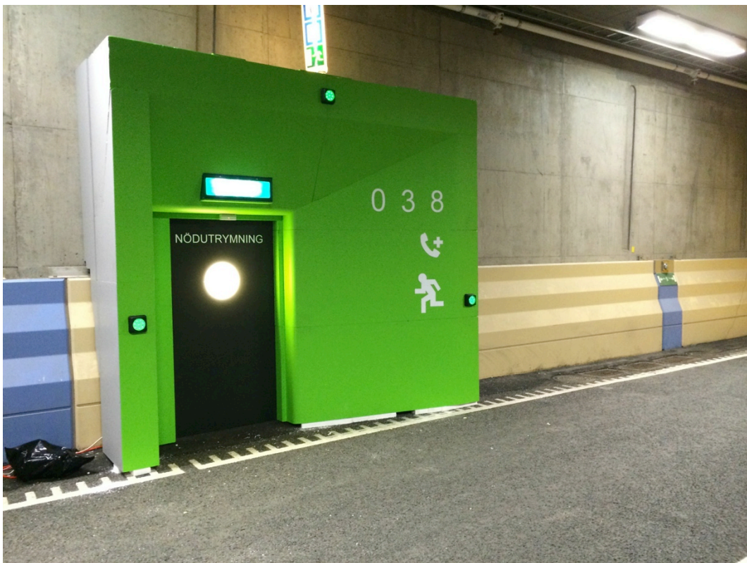
Figur 47. I slutet av den rökfyllda delen av försöksområdet installerades en utrymningsportal.
