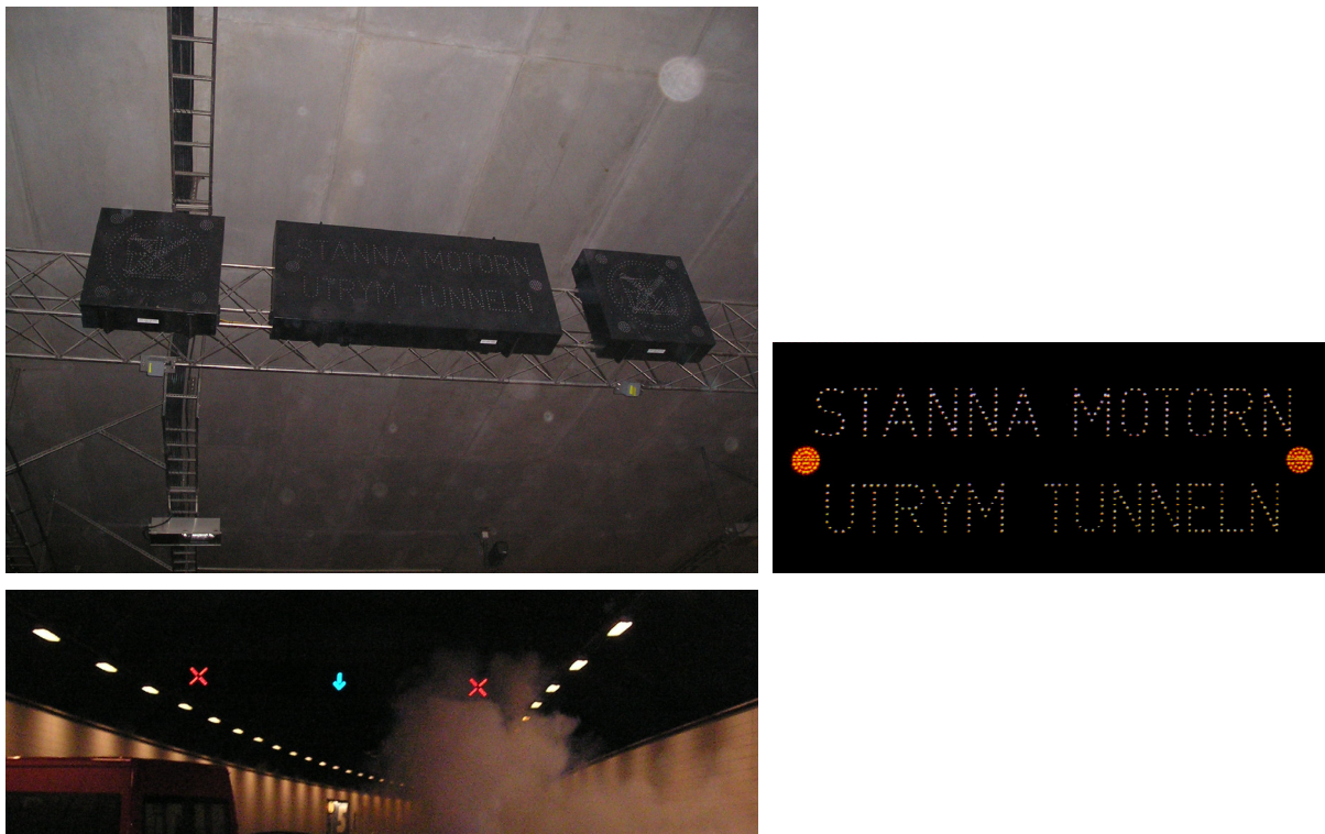
Figur 7. Informationstavla och körfältssignaler i tunneln.
