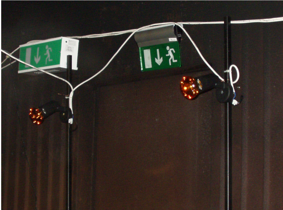
Figur 3 Utrymningsskyltar och blinklampor vid utgång till sidogång.
