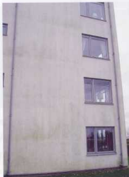
Bild 5: Fasad med påväxt av alg.
