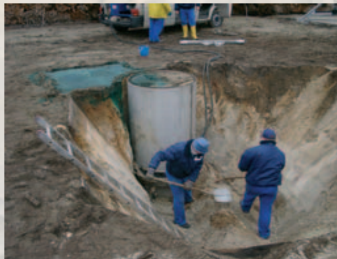
Um das Austragsverhalten von Schadstoffen in das Grundwasser zu bestimmen, wird ein Bodenmonolith entnommen. An dem Standort sind über 70 Jahre chrom- und arsenhaltige Holz imprägniermittel in den Boden eingesickert.
