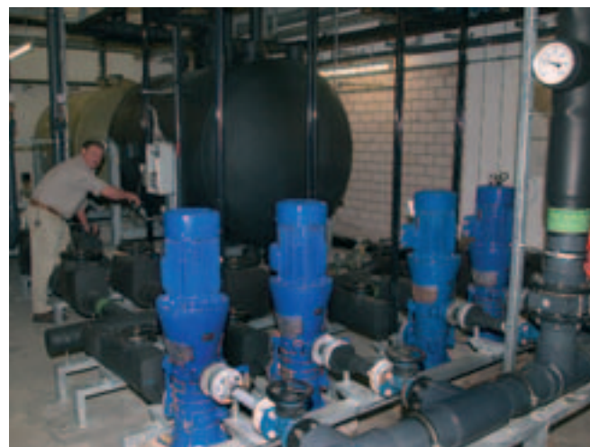
Inspektion einer VE-Anlage
