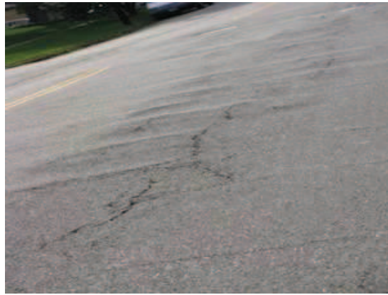
Figura 20. Ondulação em pavimento rodoviário.
