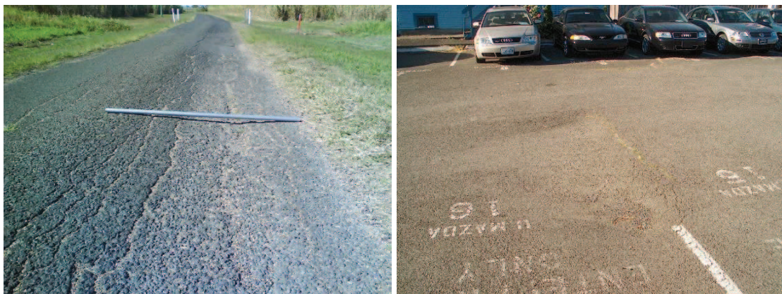
Figura 18. Abatimento longitudinal e transversal.
