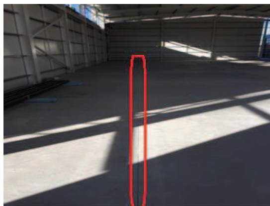
Figura 94. Junta de controlo de fendilhação na zona de contrabalanço.
