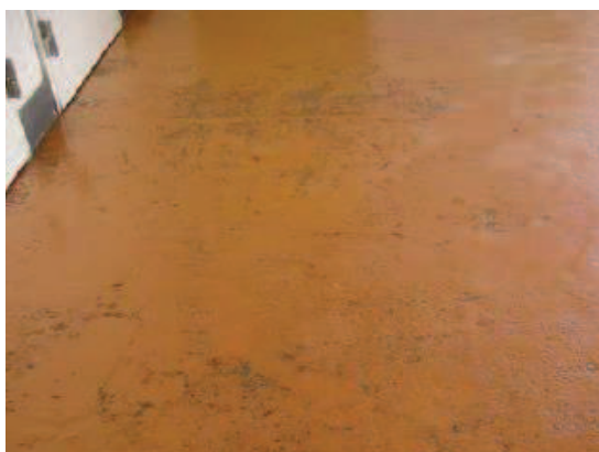
Figura 57. Pavimento em resina sintética desgastado, (Azevedo, 2010).
