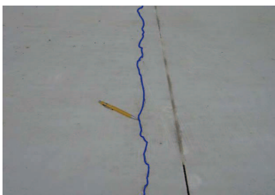
Figura 53. Fissuras de retração hidráulica, (Chodounsky, 2010).
