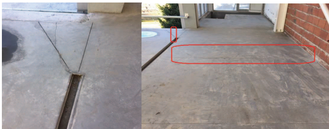
Figura 96. Fissuração em zonas frágeis.
