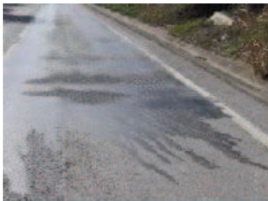
Figura 29. Exsudação em pavimento rodoviário.
