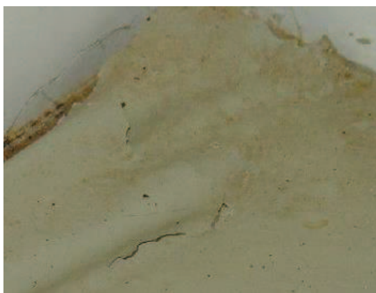
Figura 55. Empolamento do revestimento, (Azevedo, 2010).
