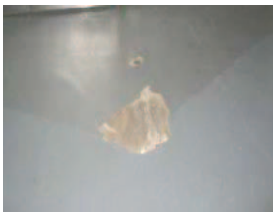
Figura 54. Descolamento do revestimento, (Azevedo, 2010).
