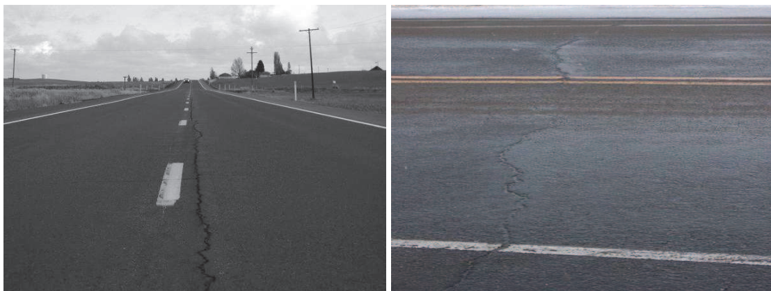
Figura 23. Fendas longitudinais e transversais.
