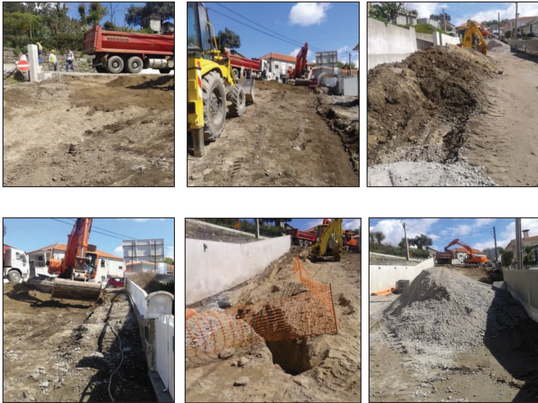
Figura 43. Situações em não conformidade.
