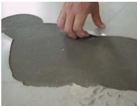
Figura 56. Descolamento do revestimento.
