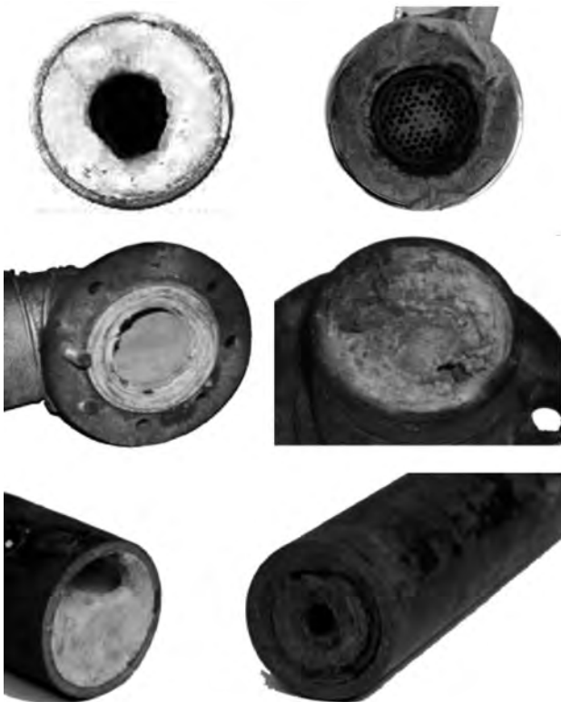
Fig. 11. Obstrucción de conducciones por depósito de incrustaciones
