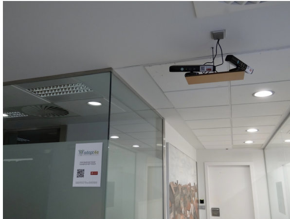
Figura 6. Imagen de la instalación final de dos cámaras Kinect en un pasillo.
