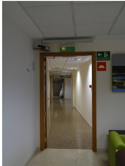
Figura 11. Imagen de una antena RFID instalada a la salida de una sala de espera.
