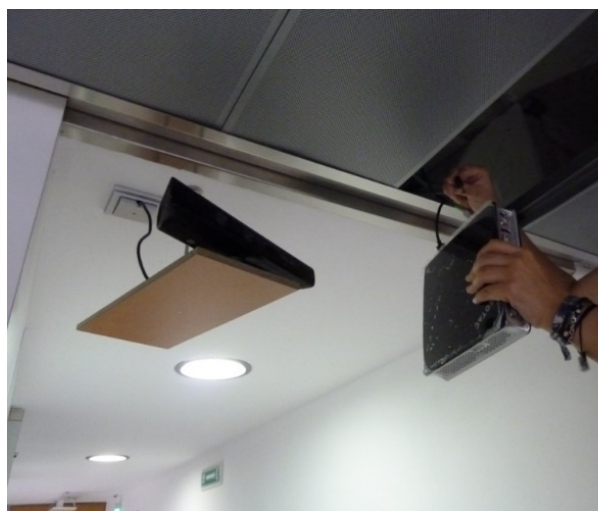
Figura 5. Momento de instalación de una cámara Kinect con su correspondiente miniPC.
