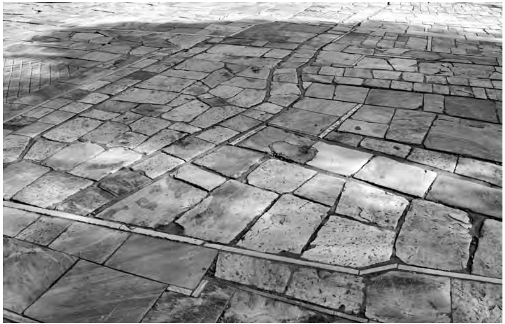
Fig. 34. Detalle de la pavimentación del camino de la Acrópolis (Fotografía Nieves Fernández Villalobos).
