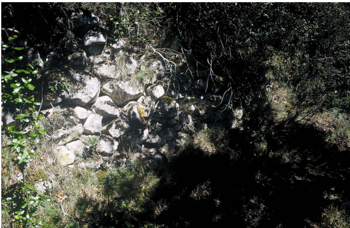
Figura 8. Detalle de uno de los muros con aparejo de sillarejo que abancalan el terreno del interior del castro.
