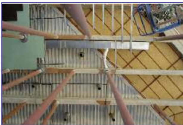
Figura 4. Montaje de los SGMs. Pueden observarse los conductos flexibles de conexión entre el conducto principal y la parte superior de los SGMs (Fot. C. Martín Gómez).
