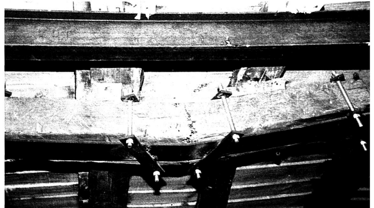
Rotura en vano de correa
