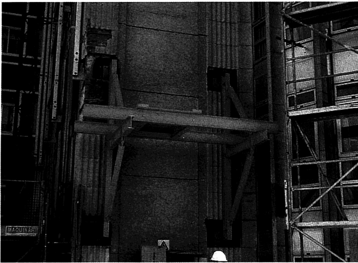
Sistema de apoyo de los andamios trepantes
