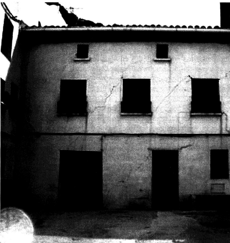
Patología por colapso en una vivienda situada en el pueblo de Mendoza. Véase la dirección izquierda-derecha del movimiento
