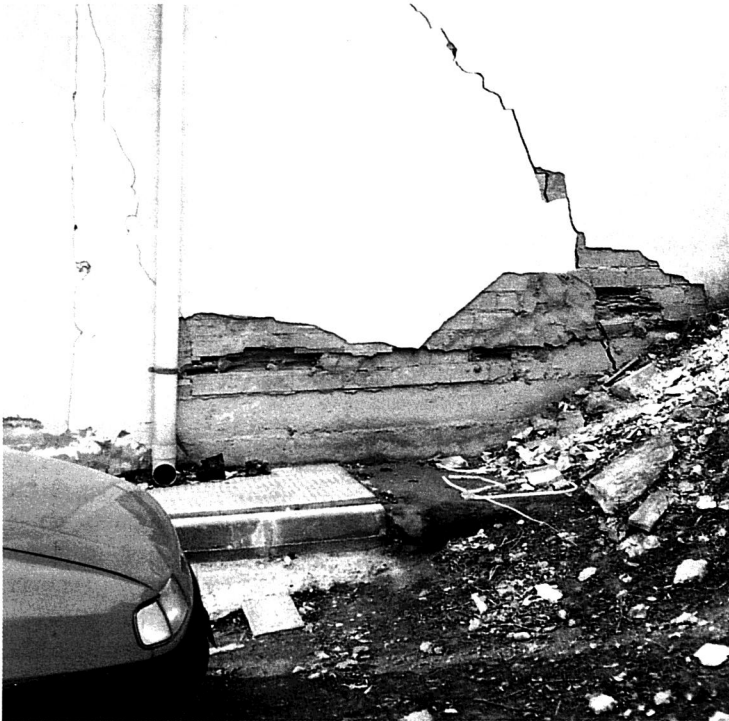
Suelo colapsable por inundación repentina en una vivienda de Lodosa
