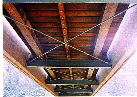
Arriostamiento en Cruz de San Andrés formando recuadros entre los montantes. Pieza de madera aserrada atornillada a los tablonos que actúa como repartidor de las cargas.
