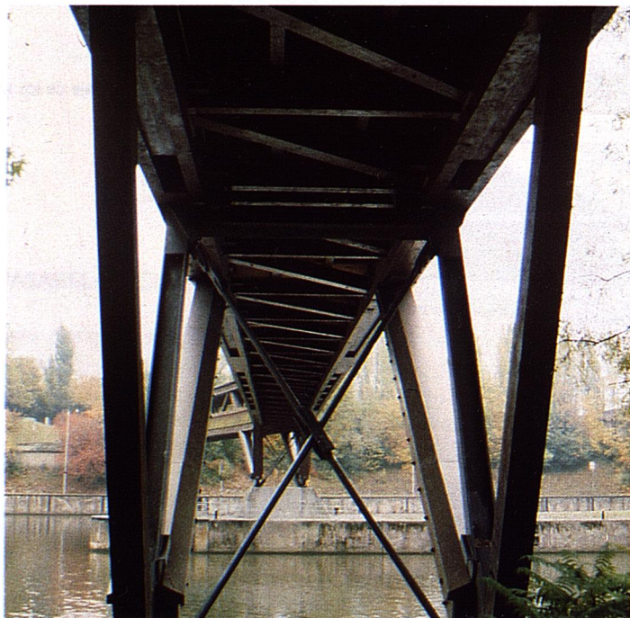
El tablero inferior de la pasarela está formado por otra celosía tipo Pratt, de montantes y diagonales. Para el apoyo del entablado, se han dispuesto al tresbolillo unos largueros para acortar el vano.
