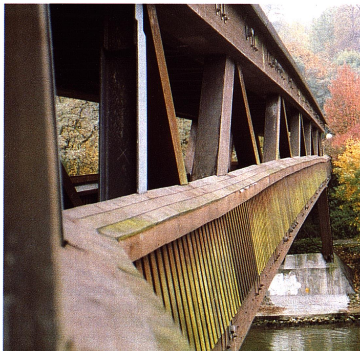
El alero es muy escaso y no protege las piezas de fachada. Para reducir el efecto del envejecimiento se ha dispuesto un forro con un entablado que a la vez constituye la barandilla. Tres tablas solapadas hacen de vierteaguas y el faldón de protección. Estas piezas pueden sustituirse con relativa facilidad.
