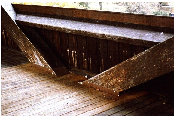
Como puede observarse parte del entablado del suelo ha sido recientemente sustituido, lo que muestra un defecto en el diseño a efectos de protección pasiva. El agua de lluvia que resbala por las caras de las barras inclinadas termina, en parte, acumulándose en el nudo de encuentro. Probablemente este hecho ha originado la degradación de la madera en esos puntos. Pueden observarse unos forros de chapa metálica que pretenden proteger los extremos de las barras inclinadas.
