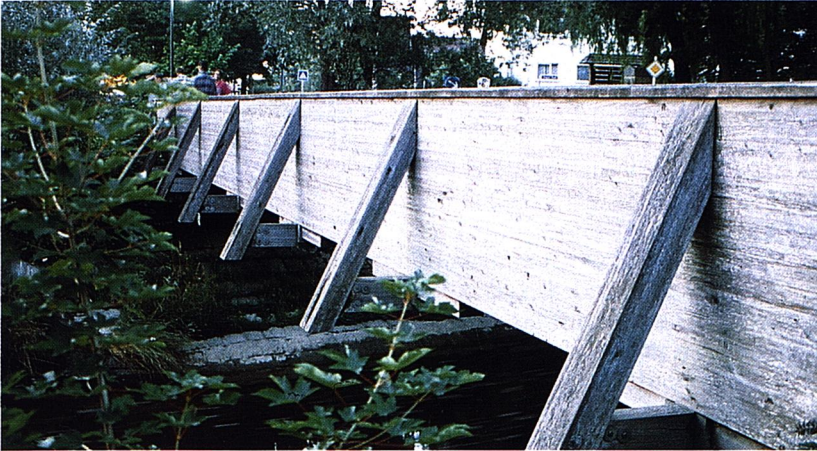
Vista general de la pasarela de Eching. Se aprecia como las tornapuntas de estabilización lateral protegen las testas de las piezas transversales (montantes).
