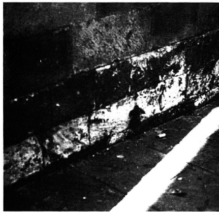
Figura 1 Eflorescencias provocadas por cristalización de las sales contenidas en las aguas de ascensión capilar. (Catedral de Jaén)
