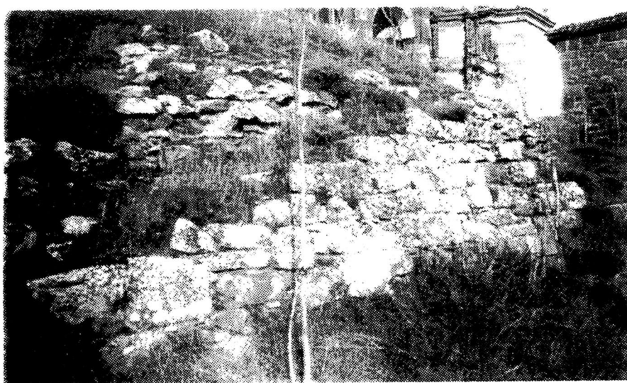
Figura 11: Muro de reutilización en la Basílica de San Gregorio (1) y posible muro de contención (2 y 3) localizados en San Gregorio .
