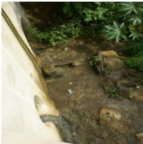
Figura 5.3. Mezcla de aguas pluviales con aguas grises contaminadas vertidas.
