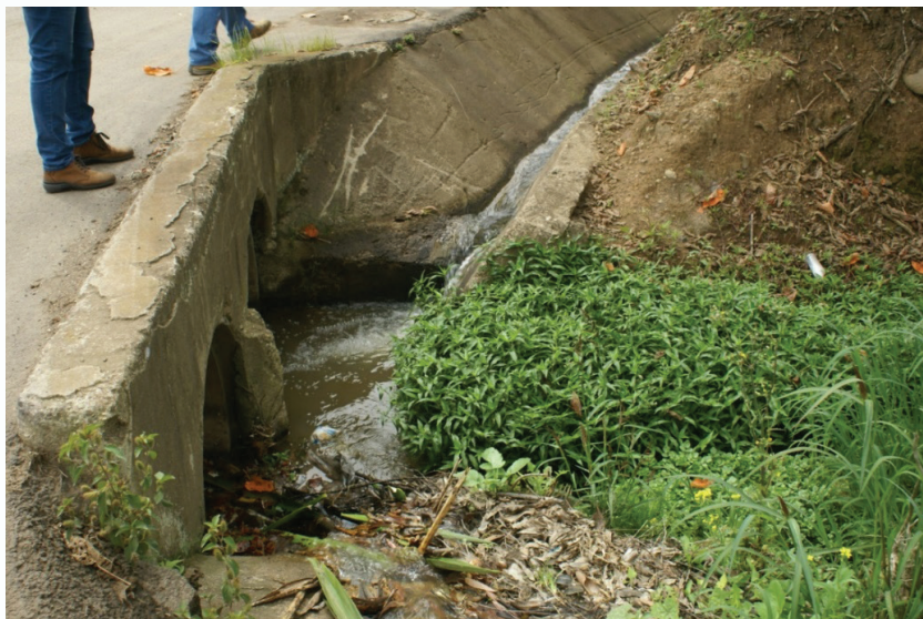
Figura 5.2. Mezcla de agua residual con aguas pluviales en la misma canalización.
