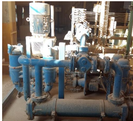
Figura 6.1.5. Sistema de lubricación del reductor principal del molino.
