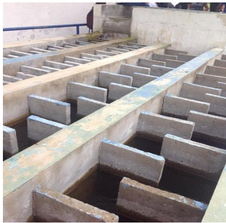
Fotografía 8: Floculador hidráulico horizontal de pantallas en concreto.
