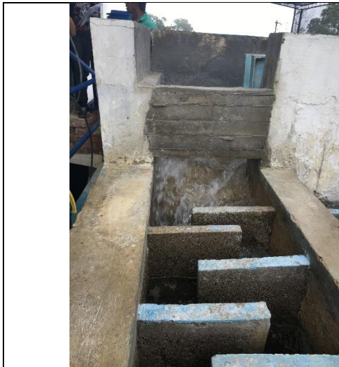
Fotografía 21: Unidad de floculación
