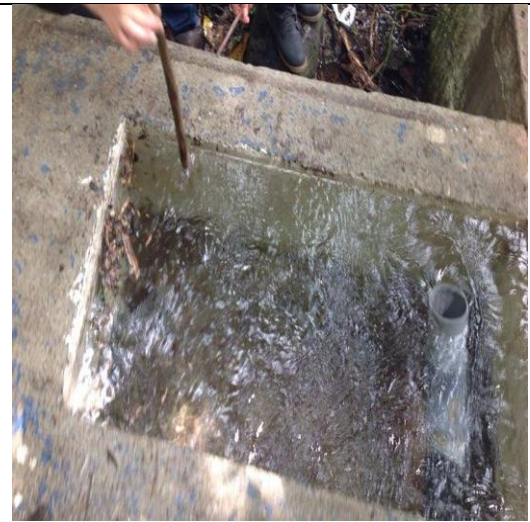
Fotografía 7: Canal de entrada.
