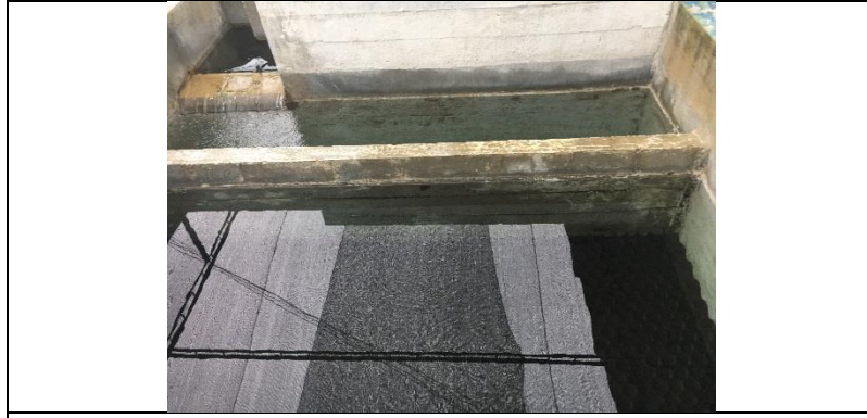
Fotografía 23: Sedimentador alta tasa de módulos hexagonales.
