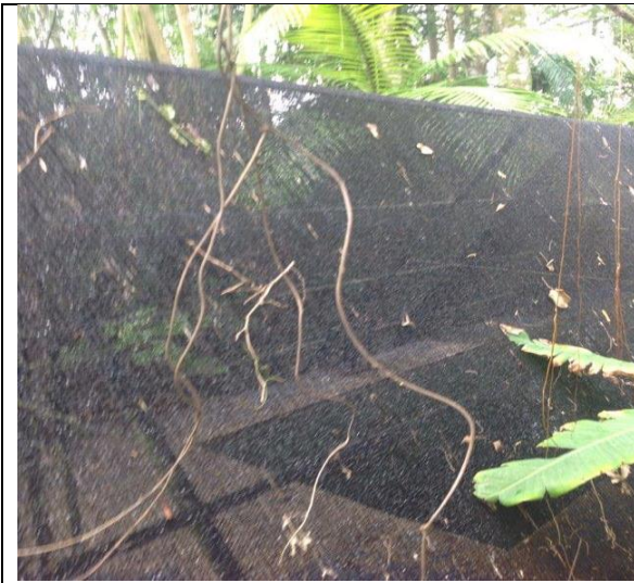
Fotografía 6: Malla que cubre el desarenador para evitar que caiga materia orgánica.
