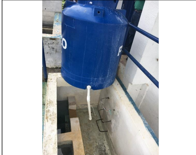
Fotografía 26: Cloración por medio de goteo.
