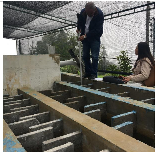
Fotografía 22: Unidad de floculación
