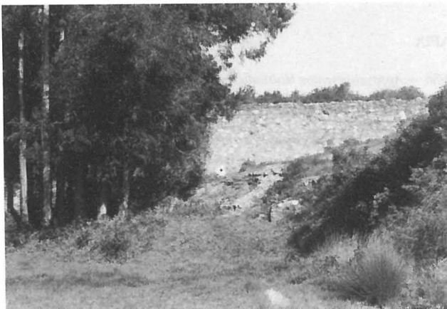
Foto 5 — Barragem da Mandorelha de Cima. Vista de montante, notando-se a abertura de uma descarga.
