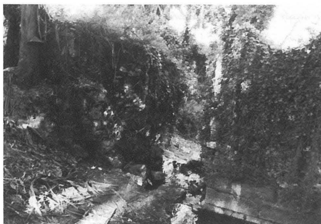
Foto 3 — Barragem da Mandorelha de Baixo. Zona da brecha, vista de montante, notando-se blocos de pedra aparelhada na base e o depósito de sedimentos.
