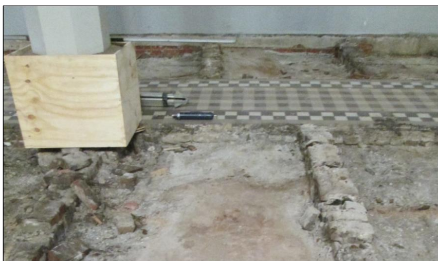
Fig. 27: De vloer uit witte en zwarte tegels voor het volledig opruimen van de vloer van de huidige kerk 35 .
