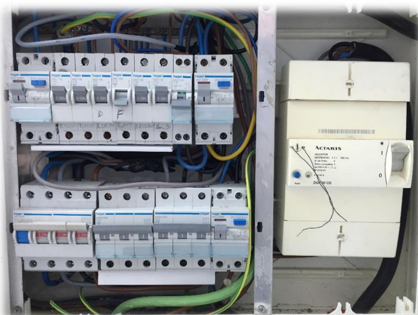
Figura 1: Quadro elétrico principal.
