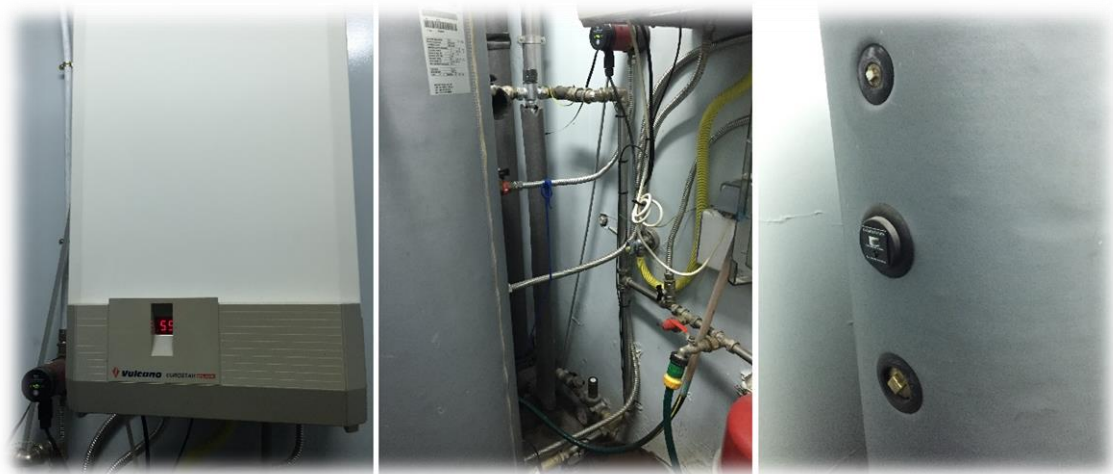
Figura 29: Instalações de AQS existentes.
