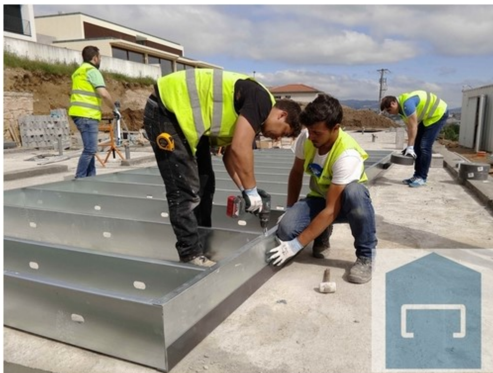
Figura 2.13 – Montagem de painéis em obra (Fonte: Fututreng.pt, Portfólio, Moradia Margaride, Visitado em 7.17.2016)
