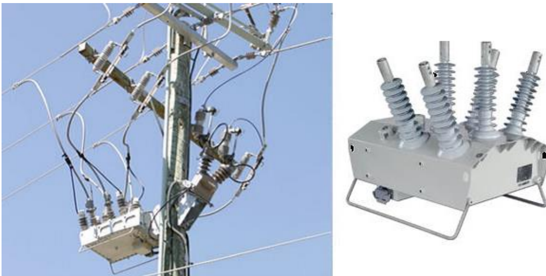
Figura 2.5 OCR3 instalado num apoio (esquerda) e em pormenor (direita).
