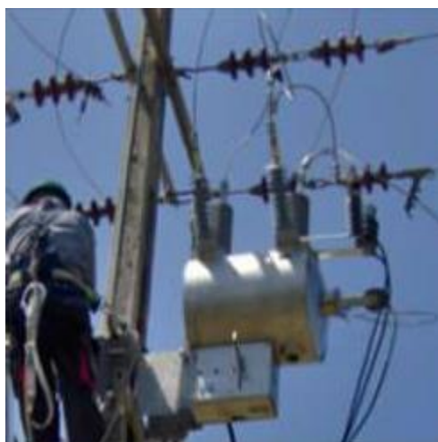
Figura 2.4 Órgão de corte de rede de média tensão do tipo 2.
