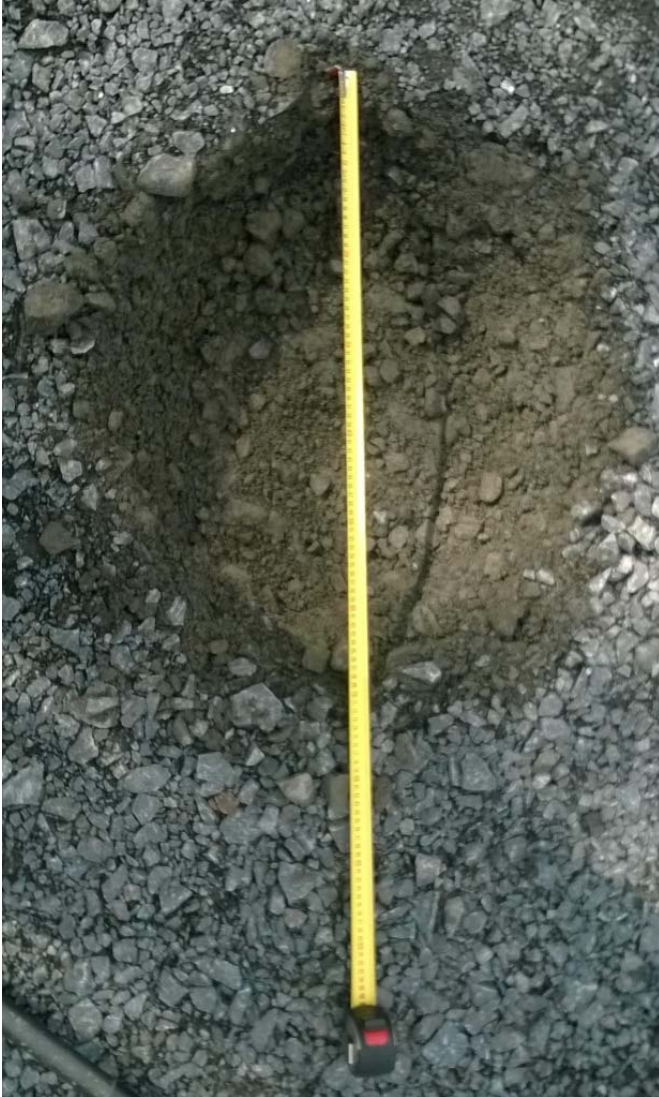
Kuva 4. Tien kantavaan kerrokseen kaivettu koekuoppa. Koekuopan halkaisija on noin 700–750 mm ja syvyys noin 150 mm.
