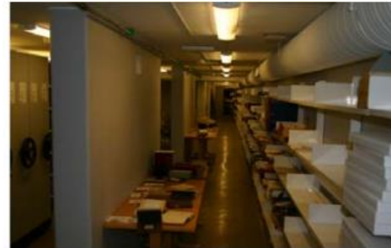
Sistema Aire Acondicionado
