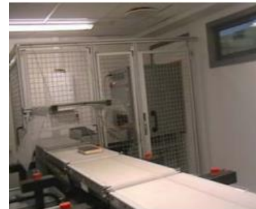
Línea de transporte con ordenamiento automático
