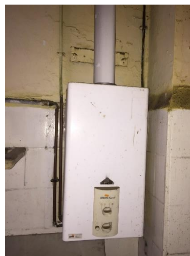
Figura 12. Foto caldera de gas natural para ACS
