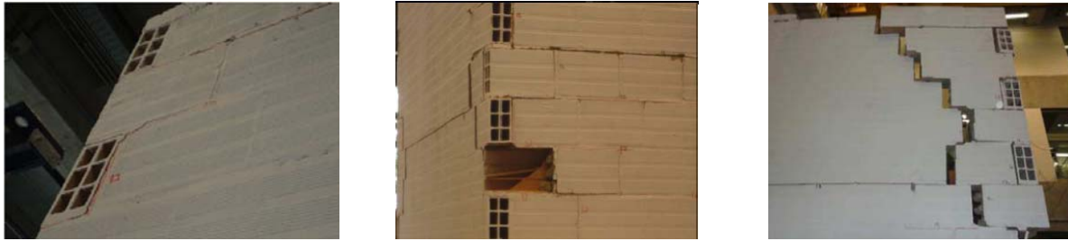
Figura 3-18 Estados de daño ilustrativos para un muro mampostería, (a) Daño leve ED1 , (b) Daño moderado ED2 , (c) Daño severo ED3 (Quiroga, 2013).
