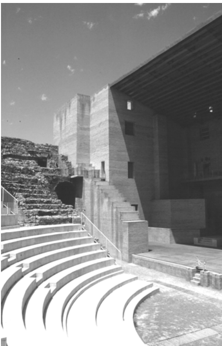
_Particolare del nodo Ovest tra il nuovo fronte scenico e la cavea. In primo piano, la nuova gradinata.
