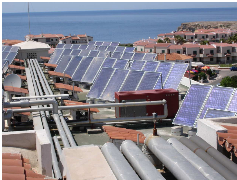
Figura 4.3.10 Instal·lació d'Energia Solar Tèrmica (subvencionada pel Govern Balear) a l'Hotel situat a Ciutadella, Menorca. Superfície de captació: 382 m 2 . Font. DG. d'energia
