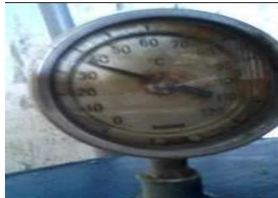
FOTO N°7: Manómetro del Vapor.
