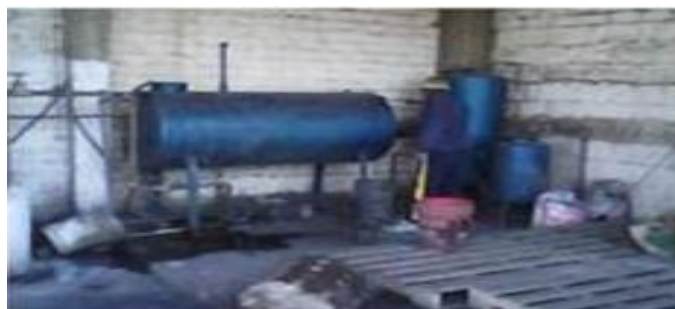
FOTO N°2: Tanque de agua de la Caldera Postes del Norte.
