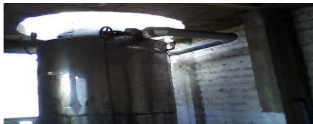
FOTO N°1: Caldera Postes del Norte.
