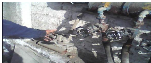
FOTO N°8: Válvulas de vapor para el secado de los postes.
