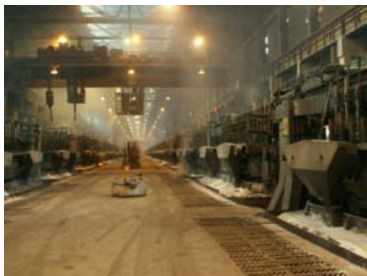
Рис. 4. Электролизеры с верхним токоподводом, оборудованные бункерами АПП
