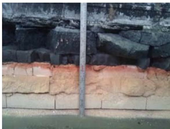
Рис. 10. Состояние футеровочных материалов в цоколе катода С-175 спустя 2310 сут службы
