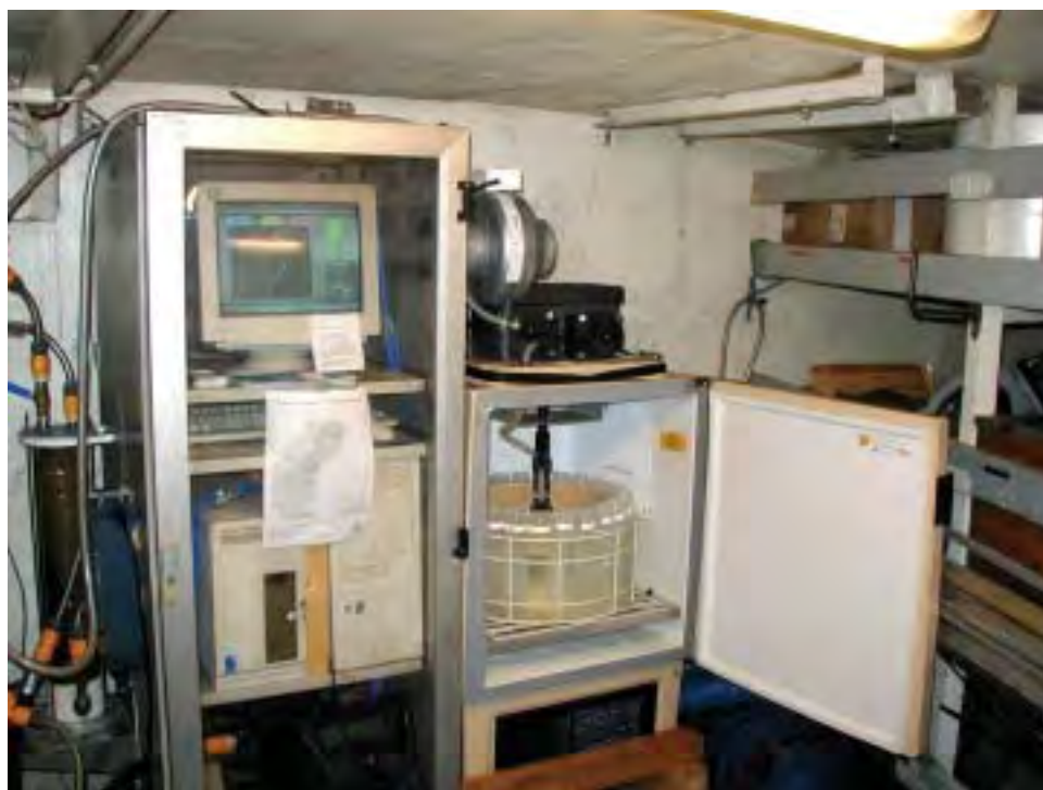
Kuva 4. Mittauslaitteet ja näytteenotin paikoilleen asennettuna vartiolaivan peräosassa.
