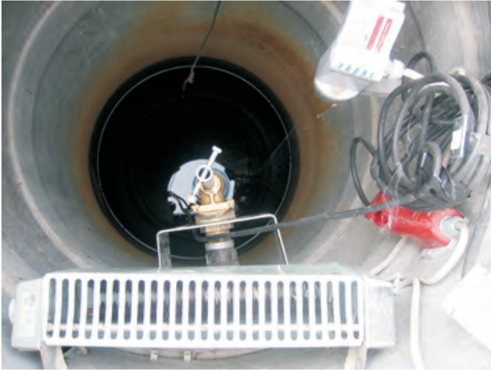
Kuva 4. Tulovesikaivo (kuva HyXo:n esittelymateriaali).
