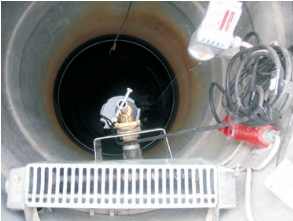
Kuva 4. Tulovesikaivo (kuva HyXo:n esittelymateriaali).
