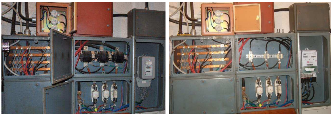
Slika 6. Predstavitve predelave merilnega mesta v poslovni stavbi GG Bled (Vir. Jani Klužar [10])
