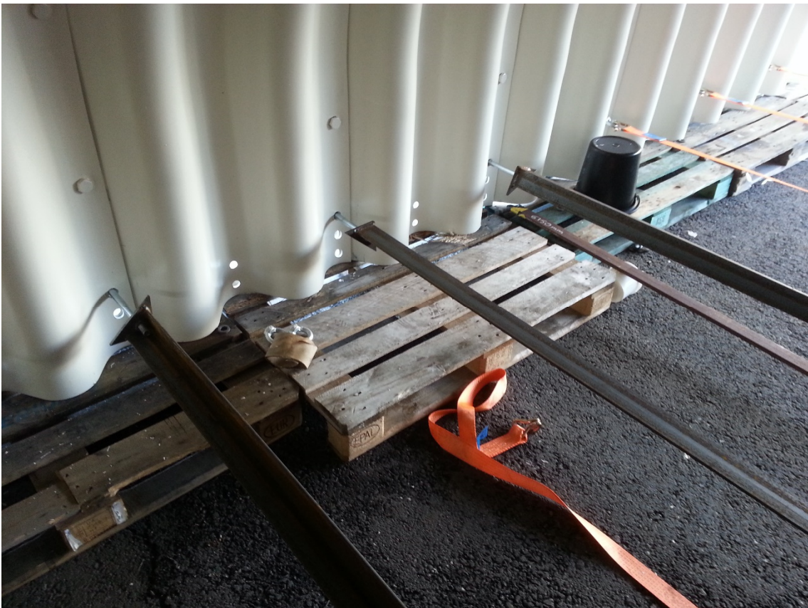
Kuva 17 Kulmateräksestä valmistettuja vetotankoja.
