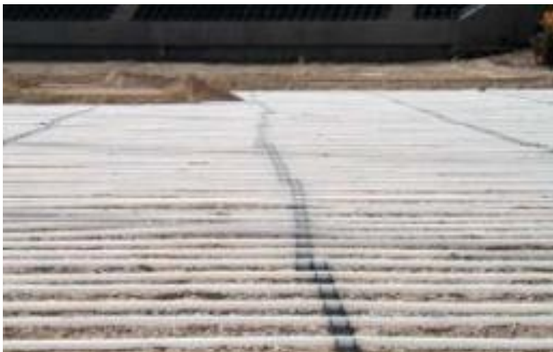
KUVA 5. Tekonurmikentän lämmitysputkisto (Football pitch heating solutions 2013)
