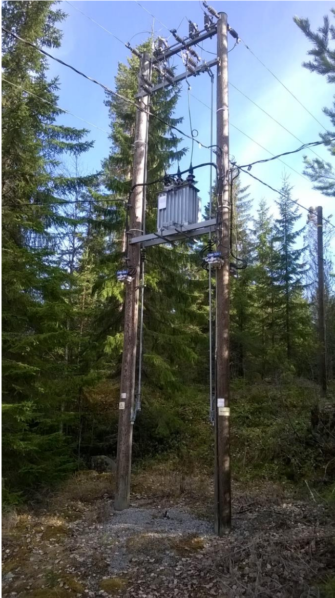
KUVA 25. Mahdollinen kytkentäpaikka erottimen E284 luona
