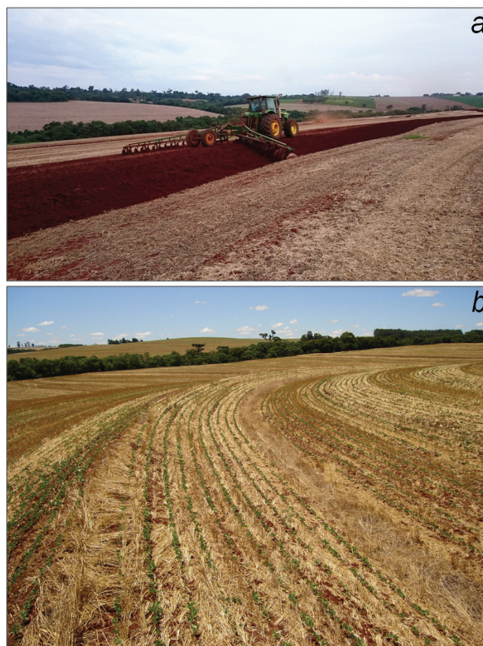
Figura 24. Práticas de manejo e conservação do solo e da água: (a) construção de terraço e (b) área com terraceamento estabelecido.
