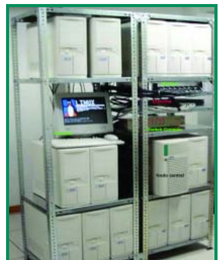
Figura 3.-Agrupación de ordenadores Pentium III, biprocesadores, de 1Gb de RAM, comunicados por Myrinet e instalado en el IAA. Se ha desarrollado dentro del Proyecto AYA 2000-1564 en colaboración con la empresa Catón Sistemas Alternativos.
